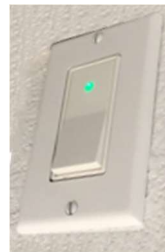
Interrupteur à bascule LED installé dans la plaque murale.
